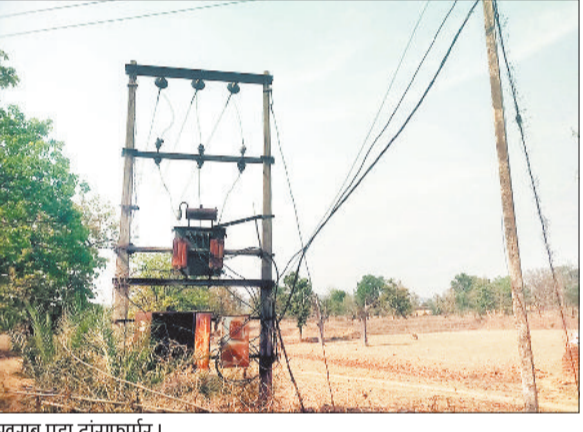
खराब पड़ा ट्रांसफार्मर।
